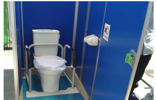
マンホールトイレ (内部)
